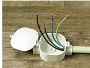
Stroomdraden in een huisinstallatie
